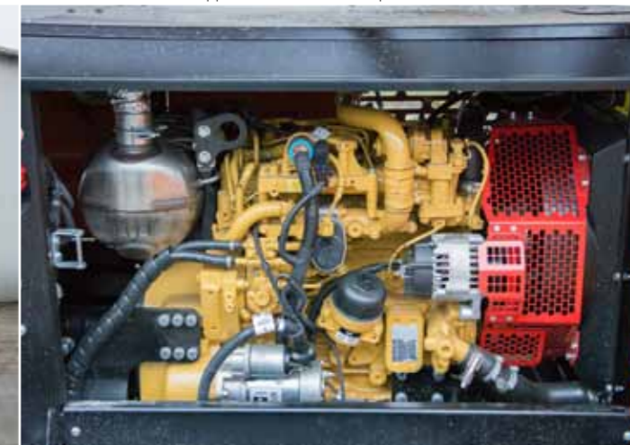
Toutes les fonctions de l'appareil sont alimentées par un moteur diesel de 55,4 kW CAT stage V
